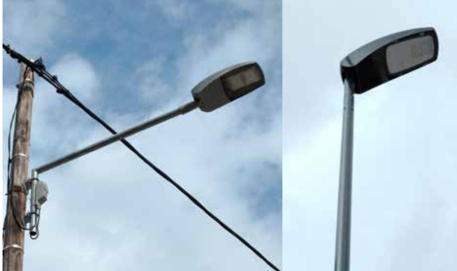
Les nouvelles lampes LED, sur les poteaux existants ou sur les nouveaux mats, comme ceux de l'avenue de la Gare.
